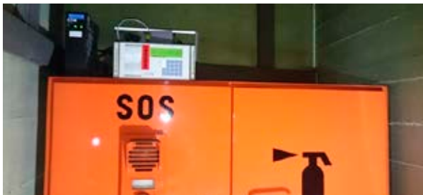
Zentralregistriergerät in der SOS Nische mit einer Pufferbatterie (in schwarz)
