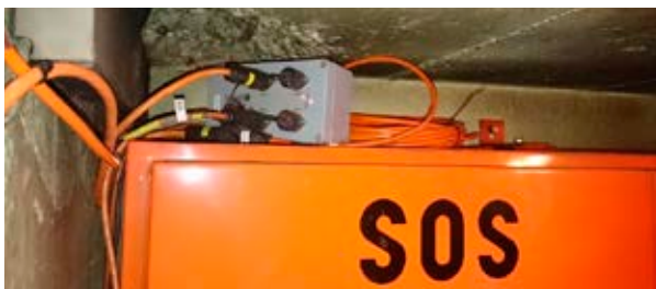
Beispiel von einer zusätzlichen Stromversorgung
