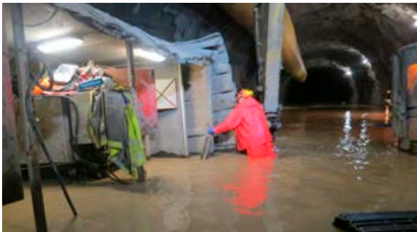
Nach dem Niederbruch flossen 480 L/sec in den Tunnel.
