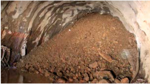
1500 m 3 Verbruchmaterial füllten den Tunnel.
