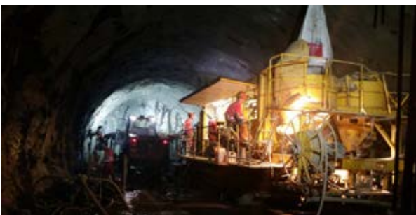
Auf einer Strecke von 2,6km wurden in 260 Etappen 2'400m 3 Zementschlämme und 324 Tonnen 2K PU-Schaum injiziert.
