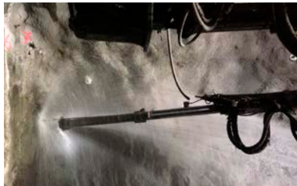
Danach konnten sie mit dem Bohrarm vorsichtig in das zu injizierende Loch geschoben werden.
